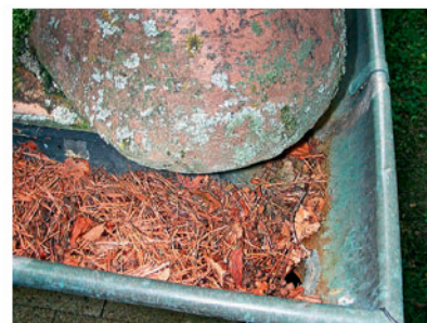
Le contrôle et le nettoyage périodiques des gouttières permettent d'éviter que les tuyaux de descente ne soient obstrués par des feuilles et des branches.
